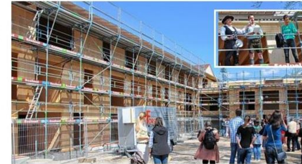
300 Gäste lockte das Richtfest für das dreigeschossige Montessori-Kinderhaus Inntal nach Brannenburg in den neuen Ortsteil Sägmühle. Max Hundhammer (kleines Foto, Mitte) von der gleichnamigen Zimmerei sprach den Richtspruch, rechts neben ihm Christine von Festenberg von der Firma InnZeit.
